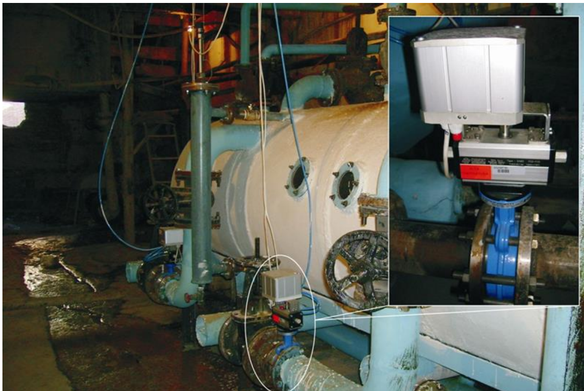
Рис. 4 – Реалізація контуру регулювання рівня в збірнику конденсату з використанням ємнісного рівнеміру та виконавчого механізму із поворотною заслінкою Samozzi
